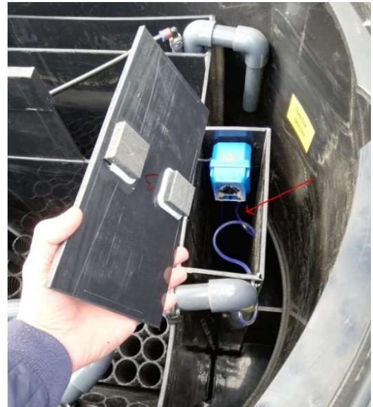
Billedet viser den indbyggede tank til fosforudfældningsmiddel med indbygget doseringspumpe
